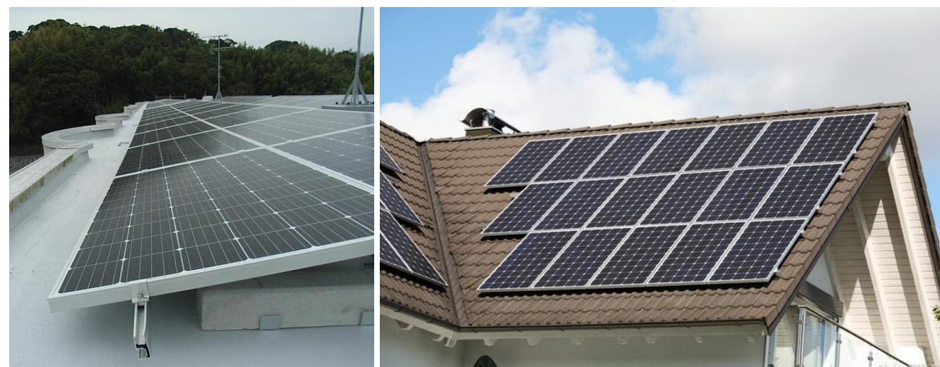
平屋面光伏板
